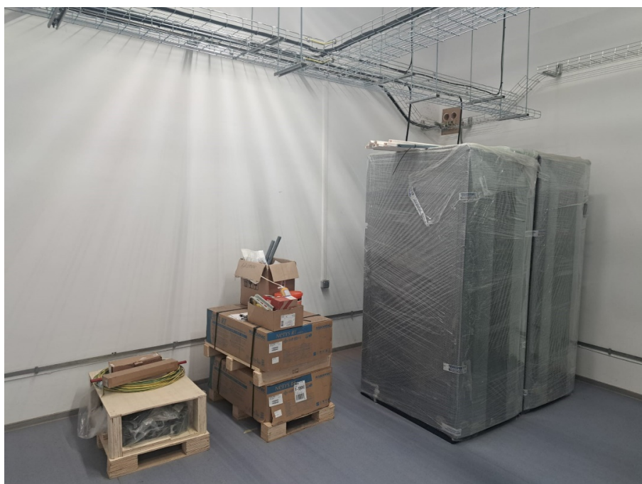
Figure 4.7: Iași Data Center
